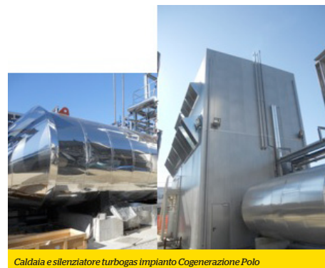
Caldaia e silenziatore turbogas impianto Cogenerazione Polo
